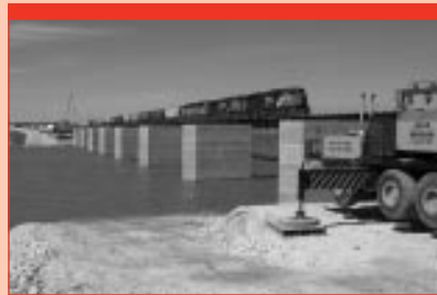
L'installation des piles temporaires du pont ferroviaire de Sprague a dû être temporairement suspendue en raison de l'ouverture du canal de dérivation au printemps de 2006. Au cours du printemps, le canal de dérivation a permis d'éviter plus de 2 milliards de dollars de dommages en inondations à Winnipeg.
