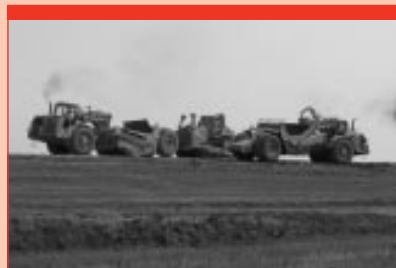
Les travaux sur la digue ouest assureront une meilleure protection contre l'action des vagues et du vent en cas d'inondation majeure.
