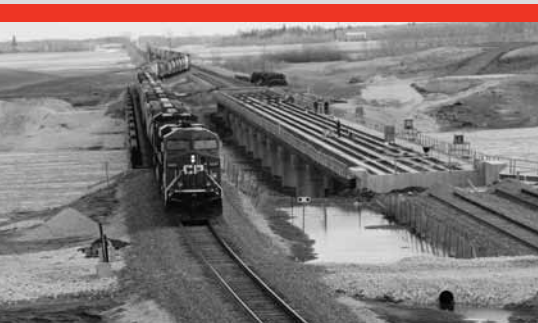
Une structure de déviation permet de détourner la circulation des trains pendant les travaux de construction du nouveau pont du CPR à Keewatin.
